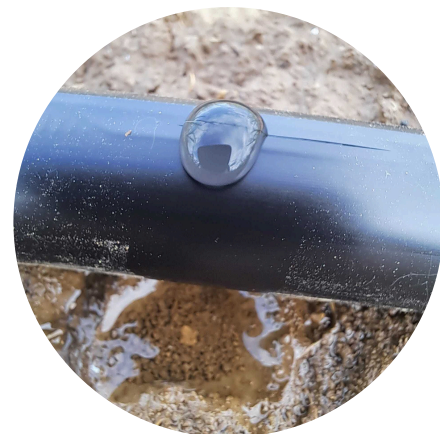
Gaine de goutte-à-goutte
